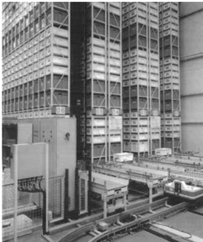
Figura 1.24. Transelevador de cajas (mini-load)
