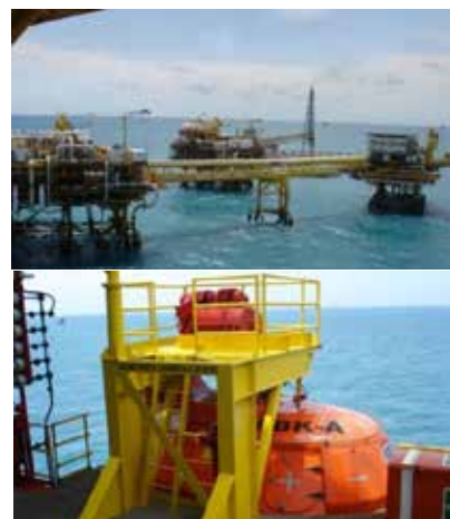
B) Intervenciones en materia mecánica
