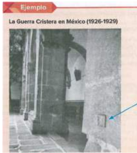
Fotografía del Claustro de San Francisco en Acámbaro, Michoacán. Se puede observar en los pilares las perforaciones que utilizaban para armar el corral de los caballos del Ejército del Gobierno Mexicano. Esto es una muestra de que las iglesias fueron ocupadas y convertidas en cuarteles.
